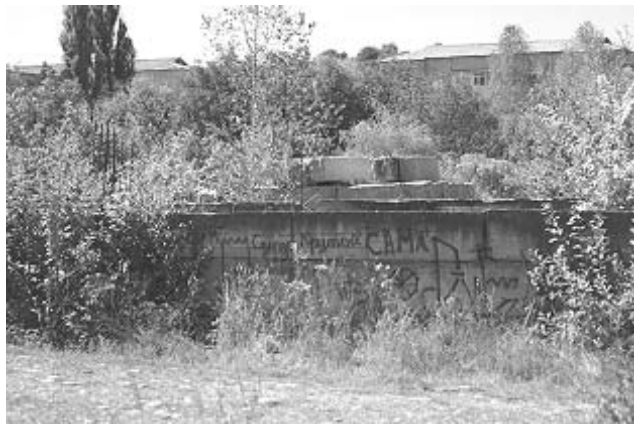
Развалины пятиэтажного дома в Медногорском, строительство которого было достроено при Советской власти до 4 этажа, а при «демократах» дом разрушен до самого фундамента...
